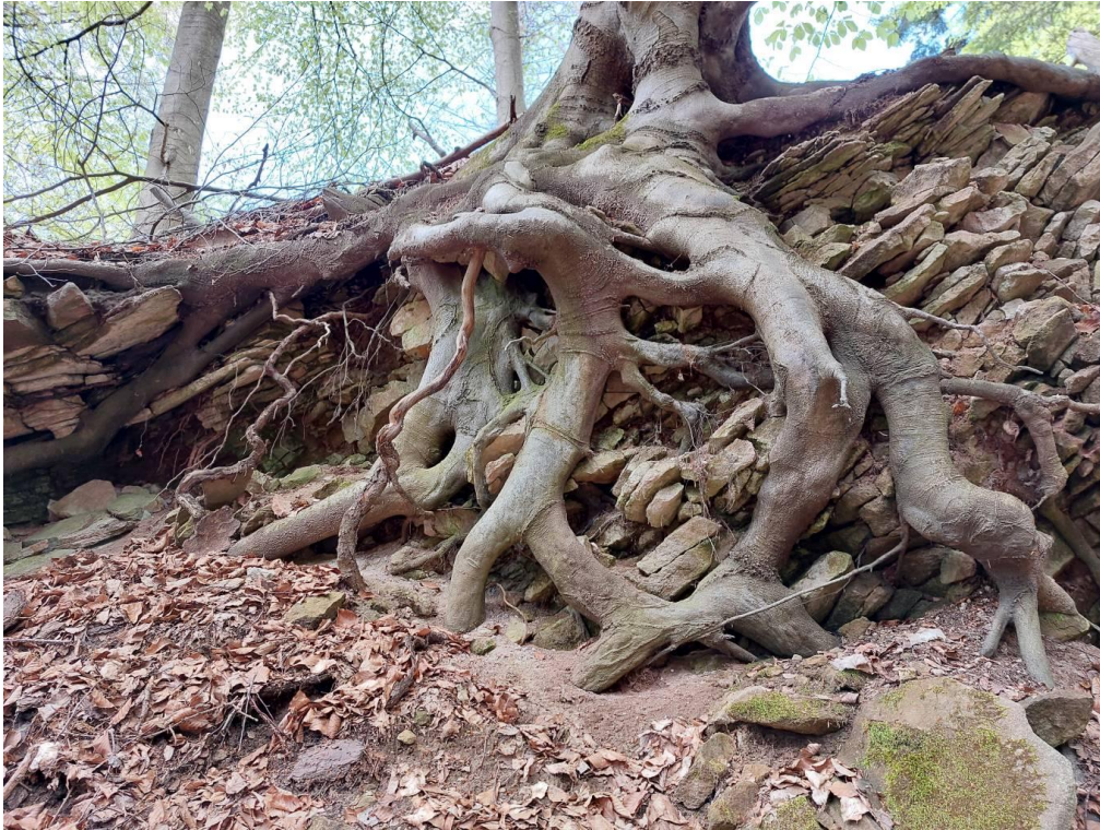
Abb. 33: Wurzeln einer Buche an der nördlichen Steinbruch-Wand mit Fleins durchsetzt
